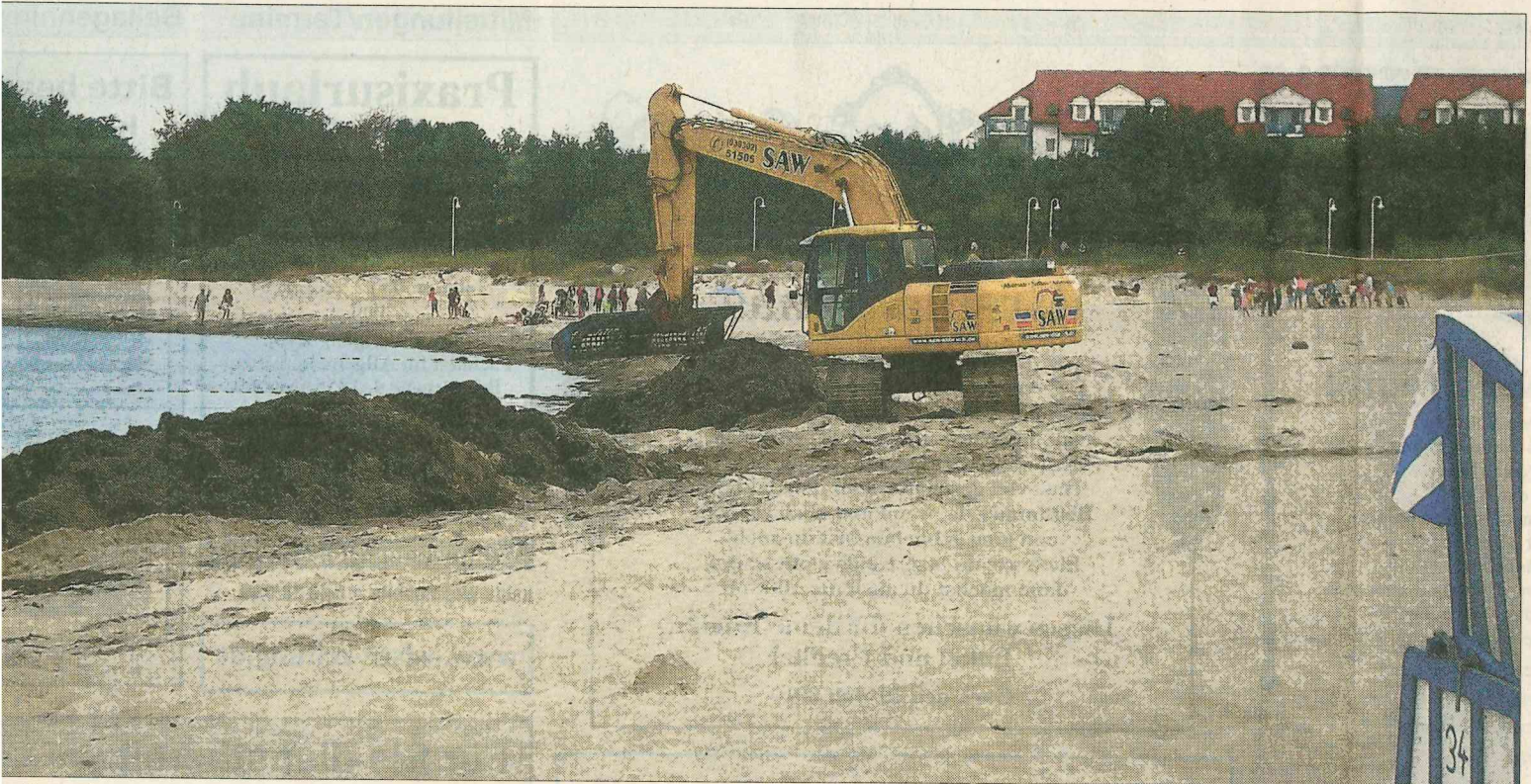
Die Kettenbagger holten Mitarbeiter der Firma SAW tonnenweise Seetang vom Glow Strand. Die Schaufel ist eine spezielle Konstruktion, die sich das Unter-eigens für diesen Zweck einfallen ließ.
