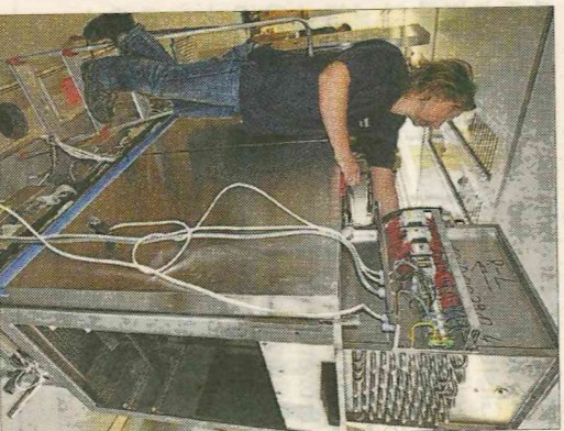
Olaf Marx schließt bereits die XXL-Spülmaschine an. Foto: ub
